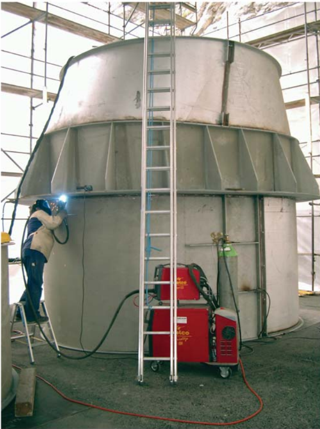
4 Preassembly of components Vormontage der Anlagenteile
